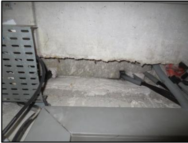
Photo N° 926 AMIANTE CIMENT -- PLACARDS TECH -1 à +4 Plafonds Plaques planes (Fibres-ciment)
